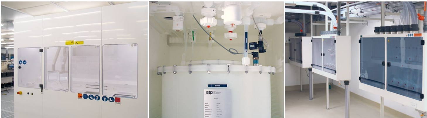
od lewej: automatyczna instalacja procesów na mokro; widok wewnętrzny systemu doprowadzania substancji chemicznych; systemy rozdzielaczy do przyłączy wyposażenia
