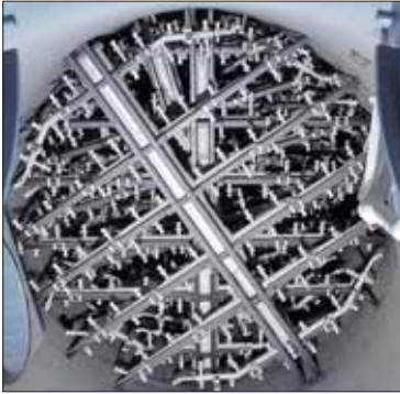
Baca gazı kükürt giderme sisteminde püskürtme boruları
