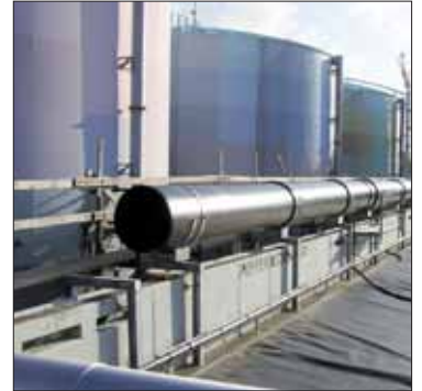
Atık gaz işleme sistemi
