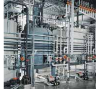
SIMONA® PVDF boru hatlarıyla kimya tesisi
