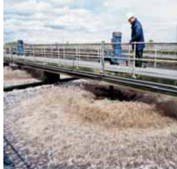
Arıtma tesisinde SIMONA® PE 100 boru sistemleri
