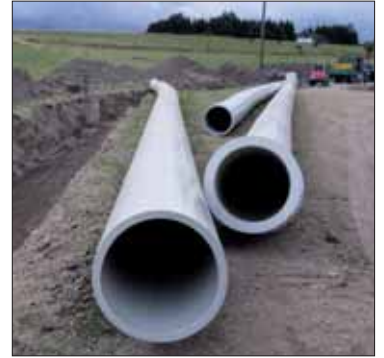
Sınai atıksu hattı
