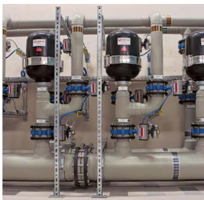
Zařízení na filtraci surové vody v rámci úpravy vody z trubek a tvarovek SIMONA® PP-H AlphaPlus®
