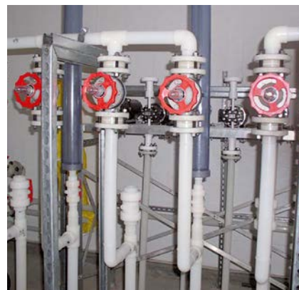
Trubky a tvarovky SIMONA® PVDF v zařízení na fluoridaci vody
