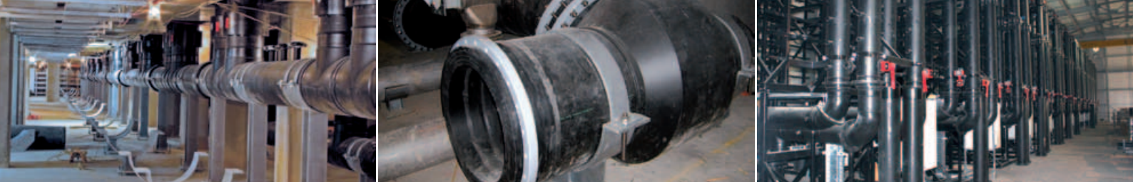
Línea colectora de PE 100 erigida sobre el suelo bajo el módulo de filtración; Columna soldada de PE 100 de 900 mm de diámetro SDR 17, incluida pieza en T reforzada de PN 10; Estructura soporte prefabricada de PE 100 para el tendido horizontal de los módulos de filtrado por ósmosis
