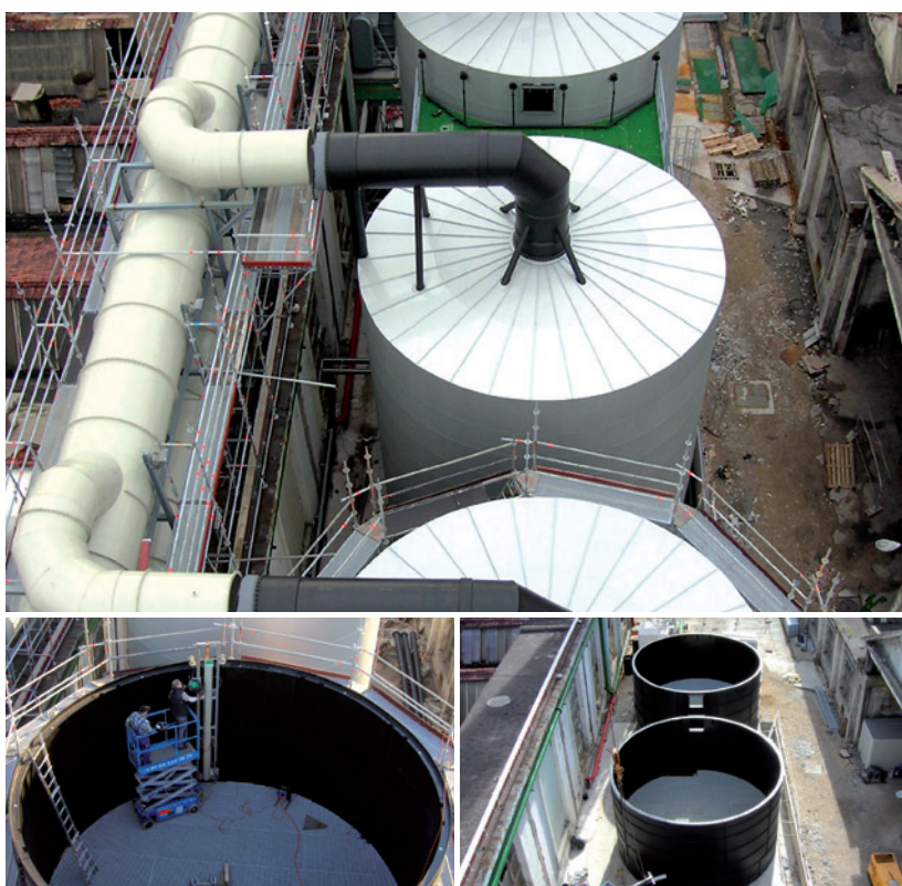
En haut : raccordement des épurateurs bio à la production.
