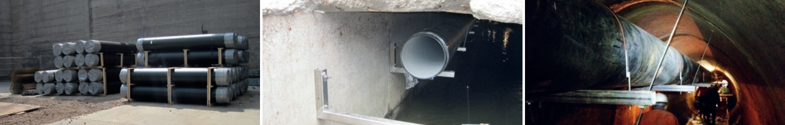
De g. à dr. : Stockage des tubes SIMOFUSE®; supports spéciaux et dispositifs d'appui pour les tubes SIMOFUSE®; tube suspendu dans la canalisation à section ovoïde
