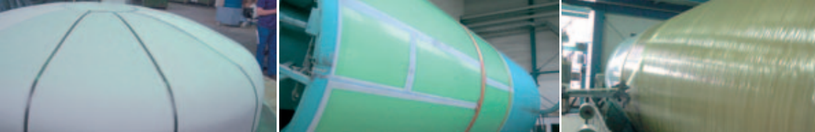
Abb. v.l. n. r.: Fertigung des gewölbten Bodens in Segmentbauweise; Zylinder aus verschweißten SIMONA® PVDF-GK Platten; Wickeln des Zylinders mit GFK auf dem Wickeldorn
