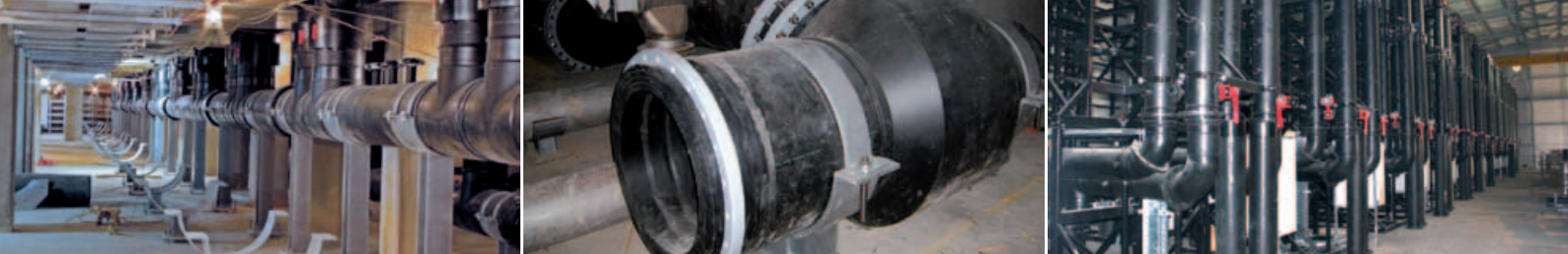
v. l. n. r.: Aufgeständerte PE 100 Sammelleitung unterhalb der Filtrationsmodule; PE 100 Schweißkolonne da 900 mm SDR 17 inkl. verstärktem T-Stück PN 10; Vorgefertigte Rahmenkonstruktion aus PE 100 zum horizontalen Einspannen der Osmose-Filtermodule
