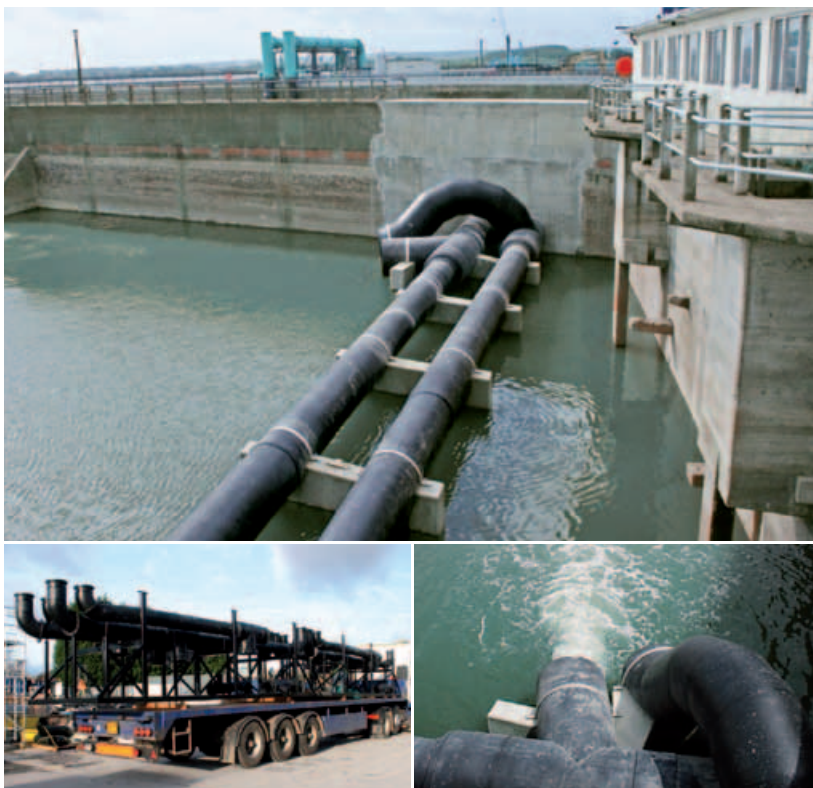
v. o. n. u.: Zulaufleitungen aus SIMONA® PE 100 Großrohren; werkseitig vorgefertigte Schweißkolonnen aus PE 100; Brackwasserspeicherbecken mit PE 100 Zulauf da 1000/1200 mm
