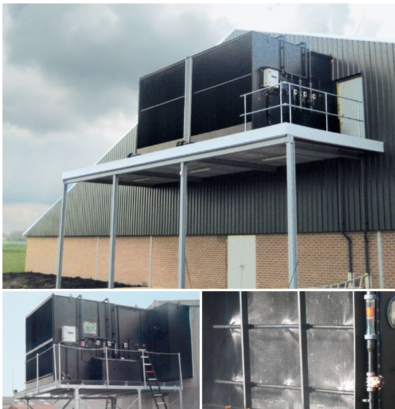
Oben/unten links: offenstehender Nitro-Air-Wäscher von KWB in den Niederlanden Unten rechts: Nitro-Air-Wäscher im Einsatz
