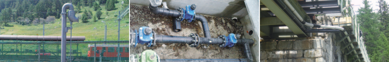
v. l. n. r.: Neubau eines Wasserkranes für die Betankung der Lokomotiven; Verteilerschacht in dem die SIMONA® PE 100 Versorgungsleitungen zusammenlaufen; Leitungen für den Wassertransport und die Sprinklersteuerung
