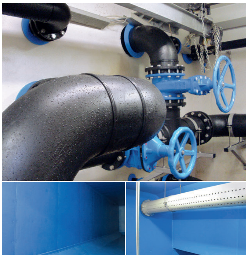
Oben: PE Verrohrung in der Vorkammer des Behälters; Unten: SIMONA® PE 340 Platten im Trinkwasserhochbehälter; Be- und Entlüftungsrohrleitung aus SIMONA® PP-H AlphaPlus®
