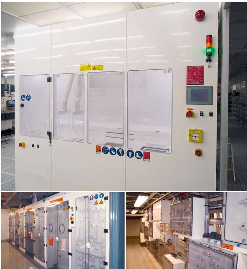
Oben: automatische Nassprozessanlage für die Bearbeitung von Siliziumscheiben; unten links: vollautomatische Versorgungssysteme für hochreine Chemikalien; unten rechts: Verteilsysteme für Equipmentanschlüsse
