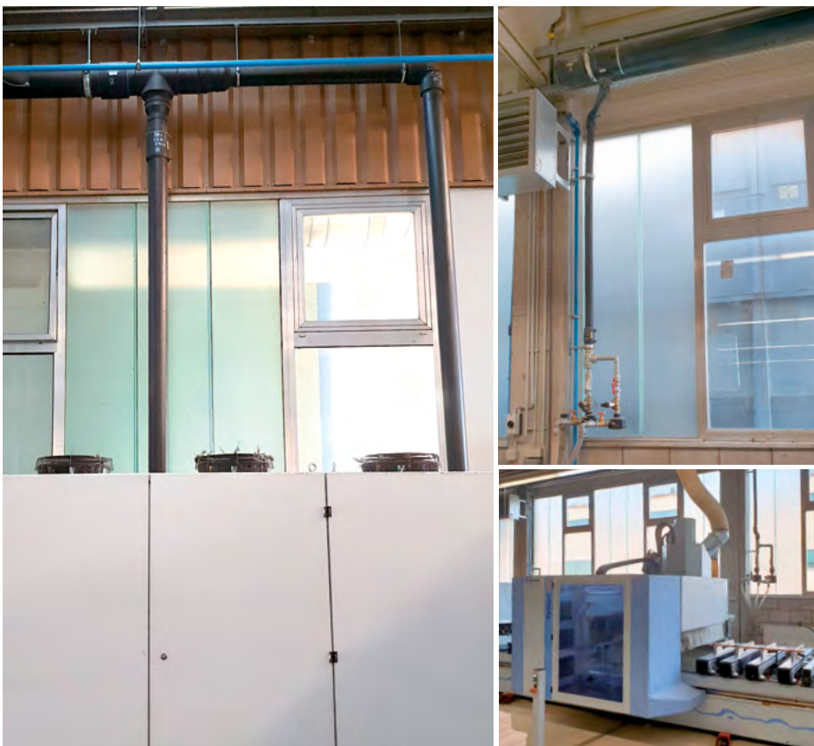
Links: Die neue, zentrale Vakuumpumpe mit den Rohrabgängen des SIMONA® PE 100 Rohr- und Formteilsystems; rechts oben: Anschluss des SIMONA® PE 100 Rohrsystems an die Holzverarbeitungsanlagen; rechts unten: CNC-Fräsmaschine
